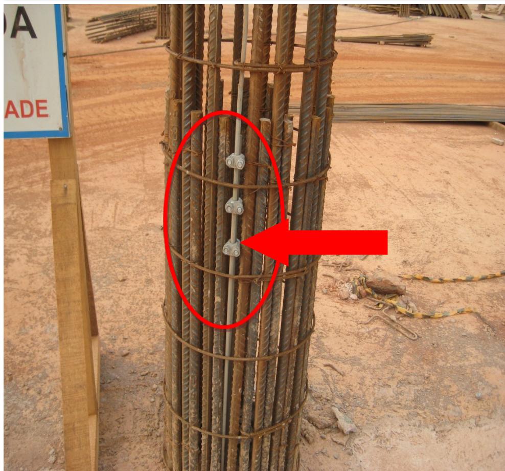
Foto 22 – Aterramento e proteção contra descargas atmosféricas
